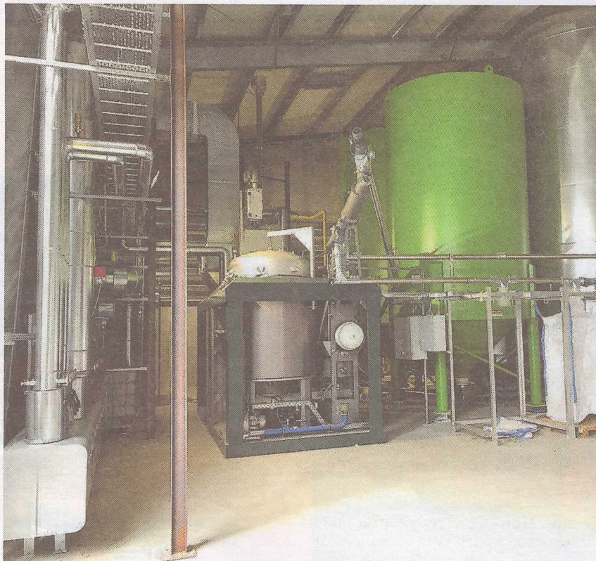
Unter dem Dach des neuen Heizkraftwerks: Holzvergaser, Pelletsilo und Wärmespeicher.
